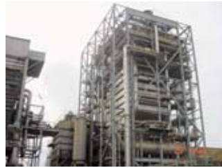
รูปที่ 1.3 หม้อไอน้ำระบบ CFB
