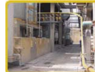
รูปที่ 2.3 โรงสาลูกจากตะกอนเข้าสู่หม้อไอน้ำ
