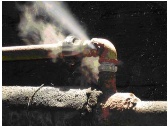
รูปที่ 9 อุปกรณ์ที่มีรอยรั่วบริเวณข้อต่อ
